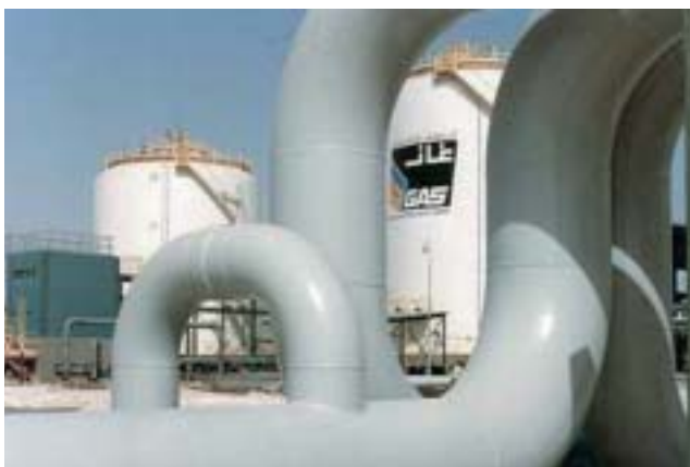
サウディアラビア基礎産業公社が所有するガス会社施設
